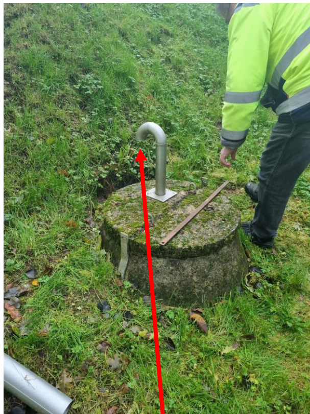
Tørbrønd, udluftning med insektnet.
