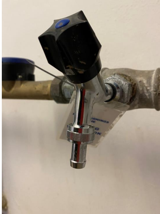
Prøvetagningshane, afgang vandværk.
